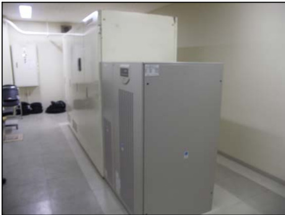
19年度 中央監視装置用無停電電源装置取替
